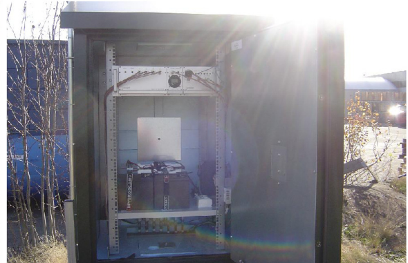
OWS in Betrieb als Hinderniswarnsystem für Hochspannungsleitungen im Fjord
