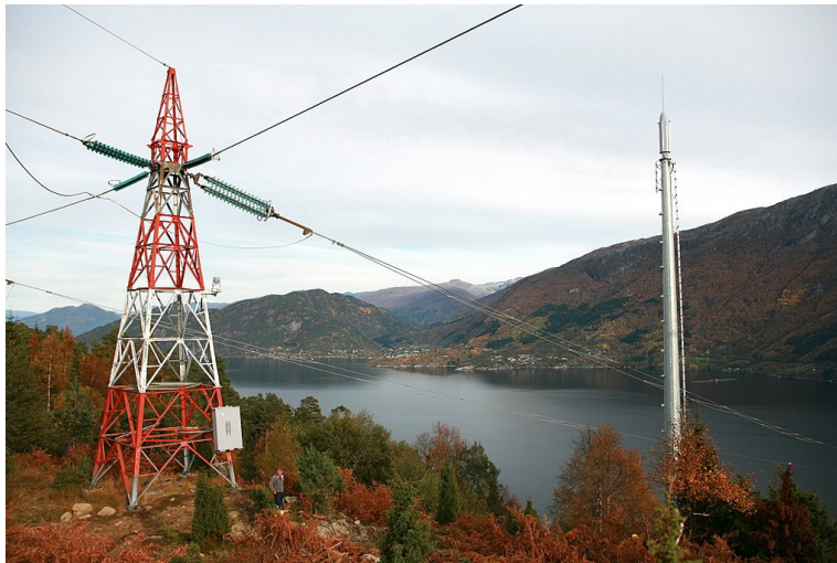
Abbildung 1: OCAS Installation in Norwegen (Quelle: OCAS)
